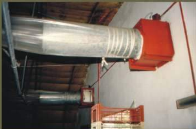
Fig. 26. Sistema de ventilación con ducto de plástico perforado para permitir una distribución homogénea del aire.
